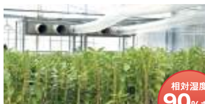
(ビニールダクトは現地調達です)
