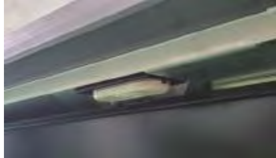
34 蹴込みコンセント
