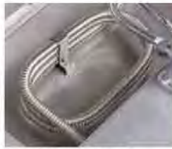
洗浄槽内のヒートコイル
